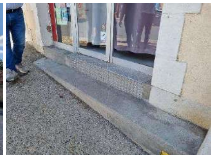
Certains commerces ne sont pas accessibles aux PMR
